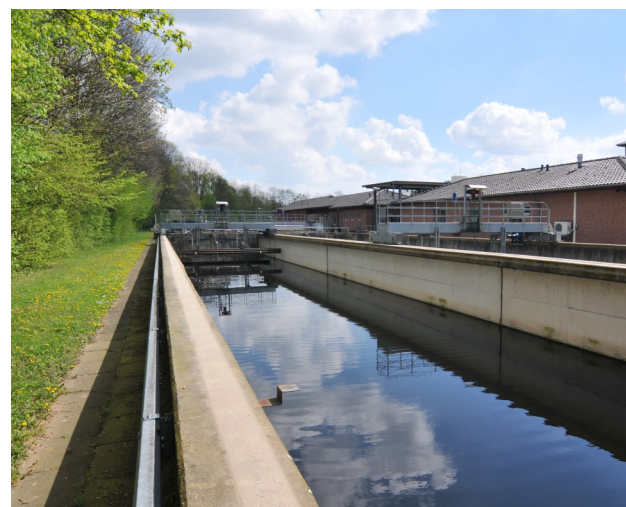
Nachklärbecken - hier endet deine Arbeit und das geklärte Abwasser kann dem Rhein zugeführt werden
